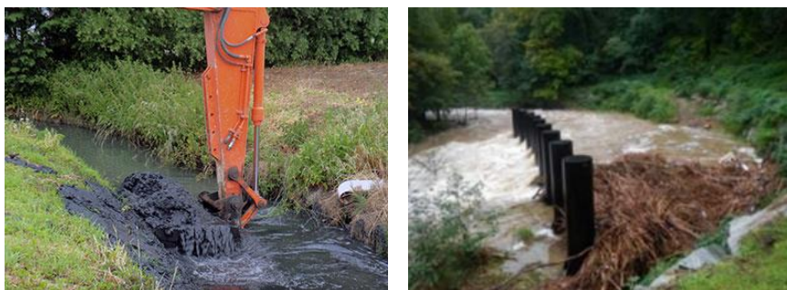
Figure 29 : Exemple de travaux de curage (à gauche) et d'un piège à embâcles (à droite) (Sources : Archives des News - Hainaut Ingénierie Technique et Plan de gestion des cours d'eau du bassin versant du Préconil 2016-2021, Riparia, août 2016 )
