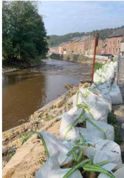
Jemelle : arrachés, les murs longeant la Lhomme ont été remplacés par des sacs de chantier. © D.R.
